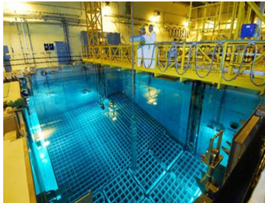
图表23：核电厂乏燃料在堆贮存水池
